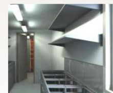
Εσωτερική όψη χώρου προσωρινής αποθήκευσης στα 4 δοχεία buffer
